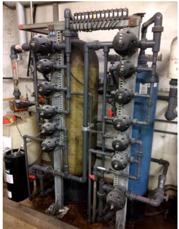
Unité de déminéralisation d'eau à deux colonnes, env. 1975
