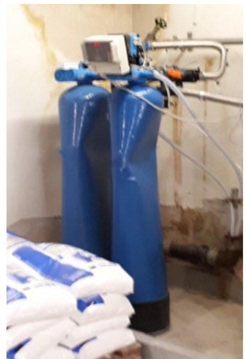
Schaden durch Unterdruck
