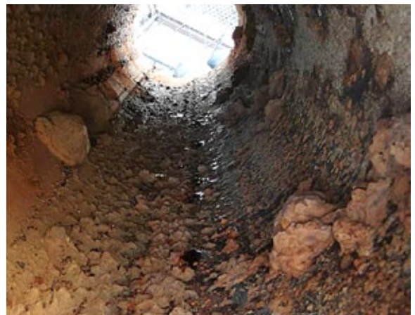
Innenansicht korrodiertes Rohr, horizontal
