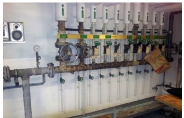
Distribution d'eau complexe, env. 1972
