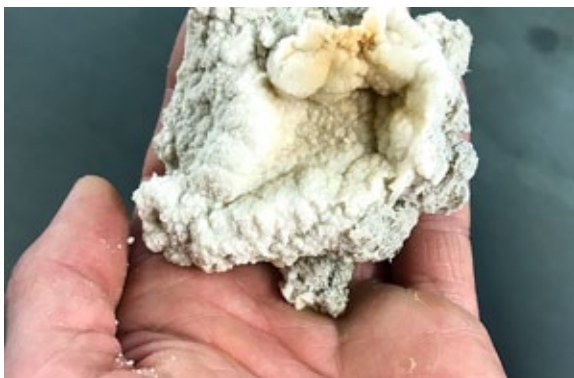
Chaux d'une tour de refroidissement
